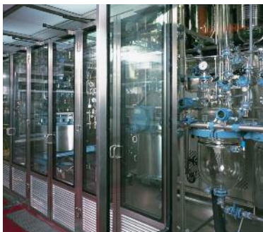
Pfizer Pilot Plant Pfizer Pilotanlage
